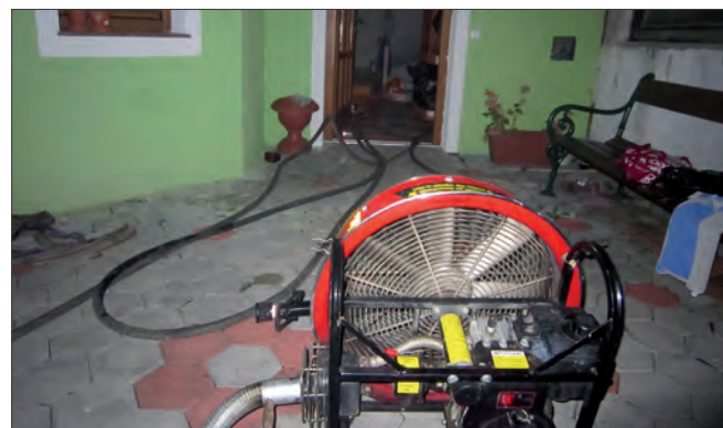
Hochdrucklüfter bei der Entrauchung des Gebäudes
